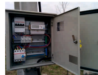
Щиты учета электроэнергии
